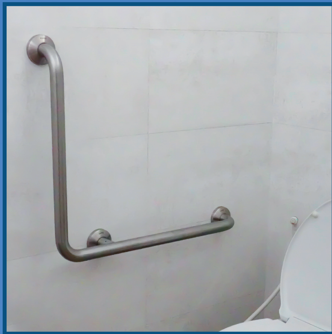
BARRA PRÓXIMA AO VASO SANITÁRIO
